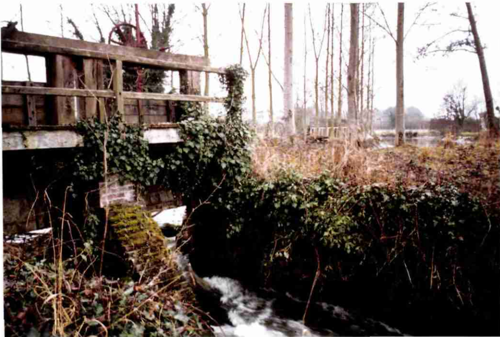
Vannes de décharge ouvertes vues depuis l'aval
