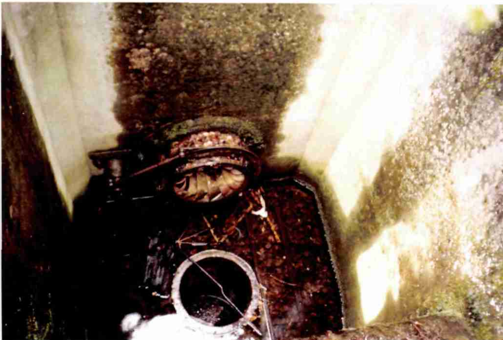
La turbine 50 KW dans sa chambre d'eau, coude dé- monté
