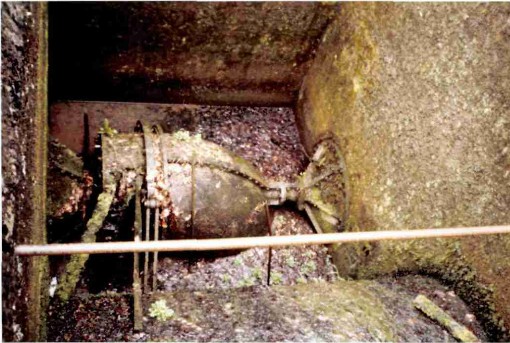
La turbine 100 KW dans sa chambre d'eau
